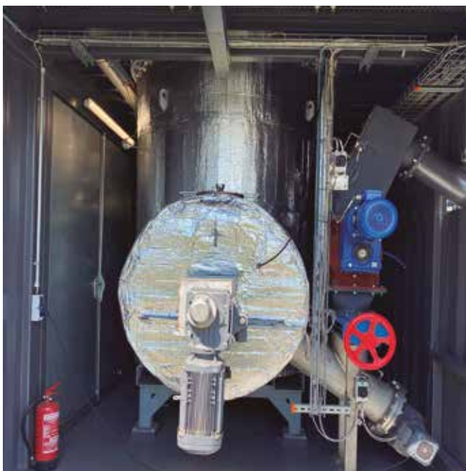
REACTOR DE PIRÓLISIS. Fuente: BIOLIZA
