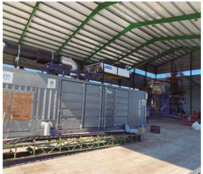
GRUPO MOTO-GENERADOR EN PLANTA DE GASIFICACIÓN DE BIOMASA. Fuente: BIOLIZA
